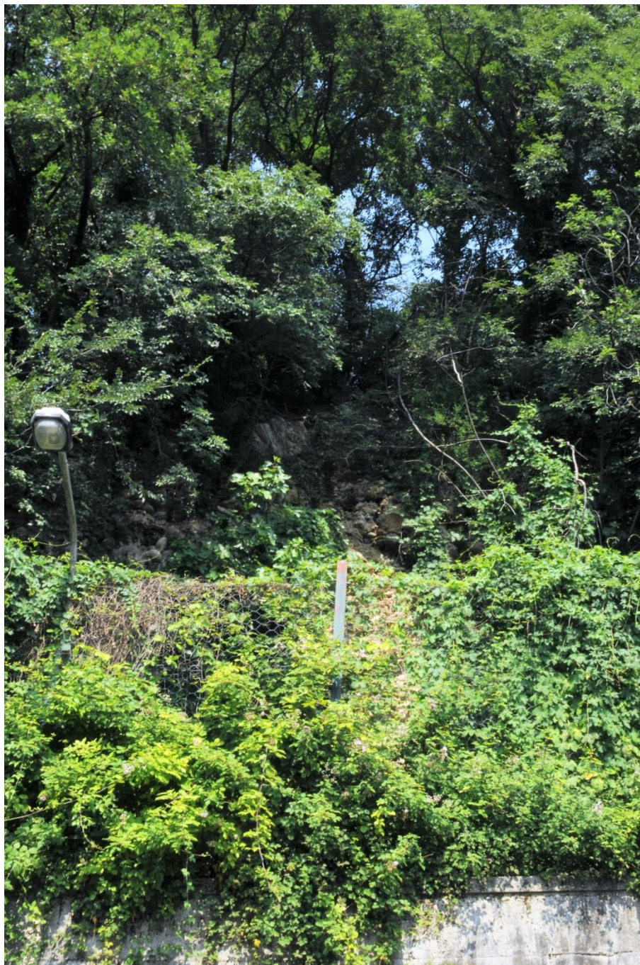
Figura 20 - Ambito 3 - Dettaglio di un movimento franoso posto a monte del muro che protegge la strada. Questo ambito è stato, ovviamente, confermato in classe "Fa"
